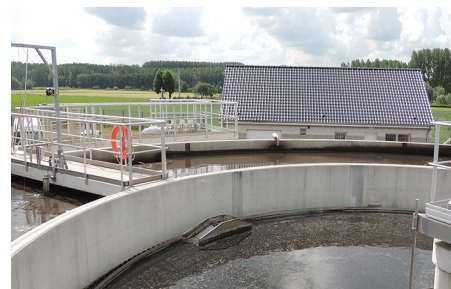
Station d'épuration de Mametz
